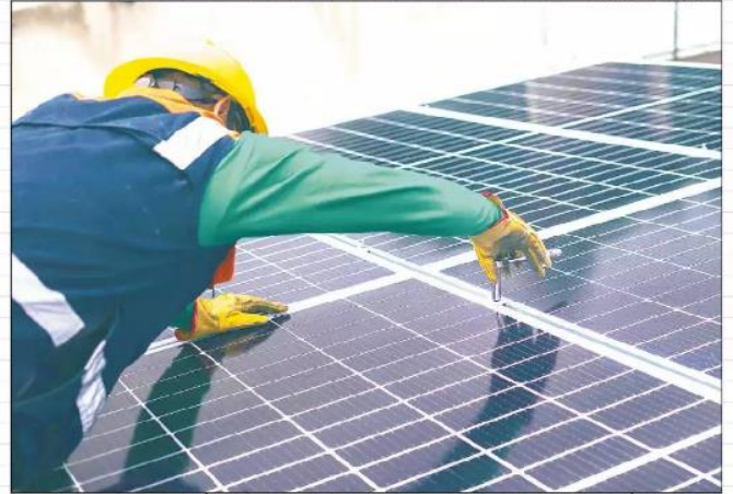
Instalação de painéis solares deve ser considerada desde a concepção do projeto
