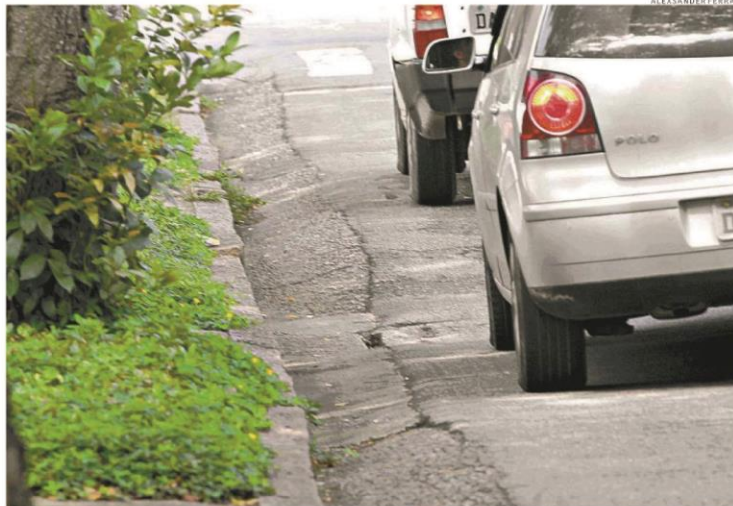
Pavimentação péssima é vista nas principais vias de Santos, como no Canal 1, onde há desníveis e trincas
